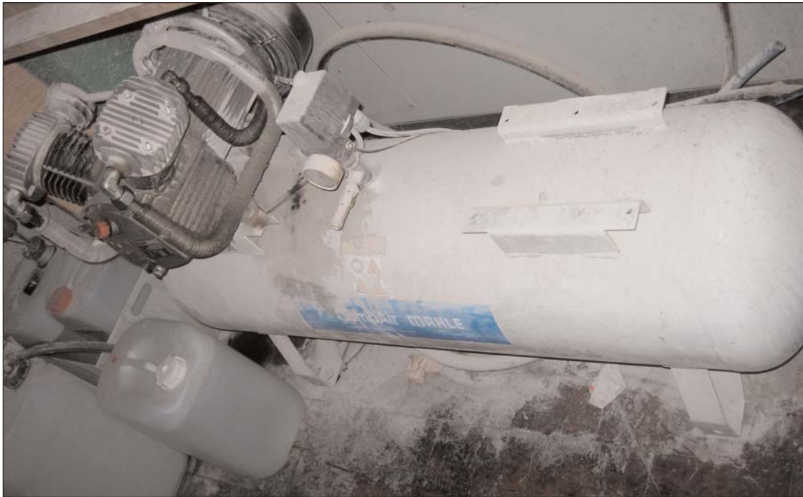
Energie- und Geldverschwendung: eine verfallene und schmutzige Druckluftanlage.
