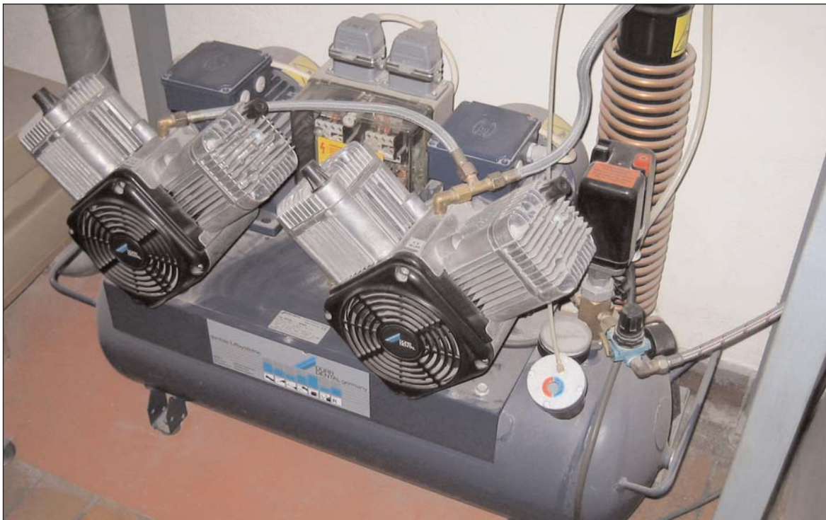
Energieeffizient: ein moderner und gut gewarteter Druckluftkompressor.
